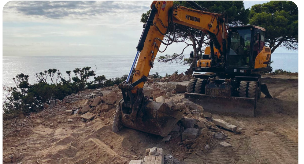
/ El Passeig de les Cales és una de les reivindicacions històriques per millorar aquesta zona, que no és de competència municipal
