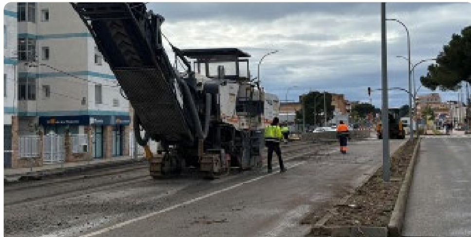
/ La fase 3 actua des de plaça Tarragona fins a l'avinguda M. Cristina
