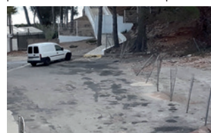
El mal estat de l'accés a la base nàutica.
