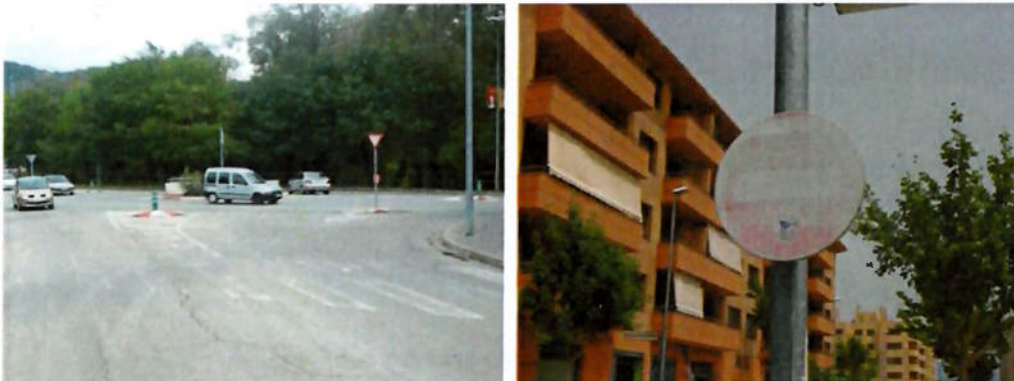
Imatge 63. Senyalització en estat deficient
