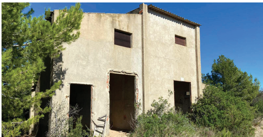
Casa abandonada a la vora del circuit de motocròs dins l'àmbit d'estudi
