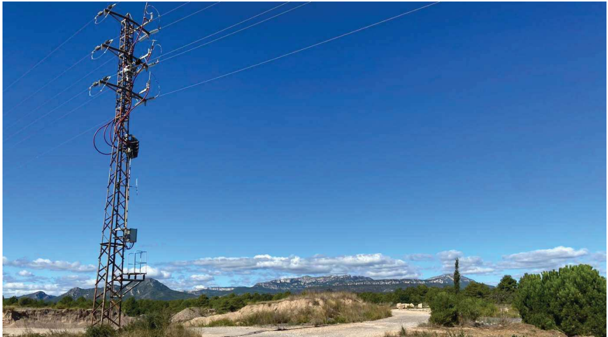
Línia de mitja tensió l sector dels Comellarets.
